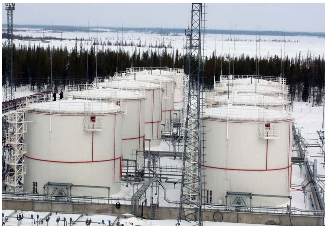
Рис. 1. Общий вид резервуарного парка
